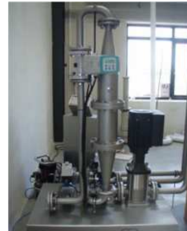
MWTP (Micro WTP 5 m 3 /h)
